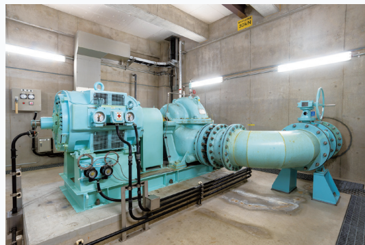
写真4 小水力発電*設備（水運用センター）
