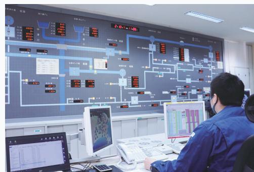
写真1 水運用センター 管理室
