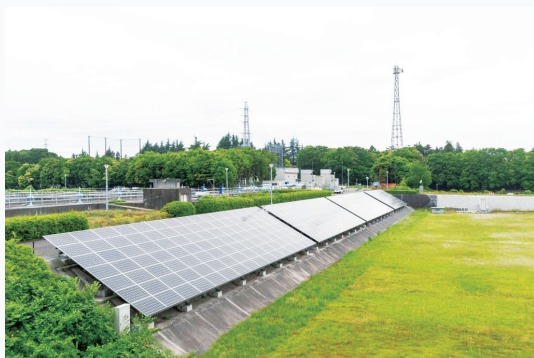
写真3 太陽光発電設備（相模原浄水場）
