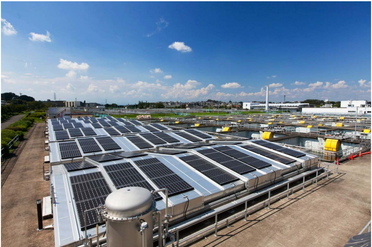
(西長沢浄水場、ろ過池と太陽光発電設備)
